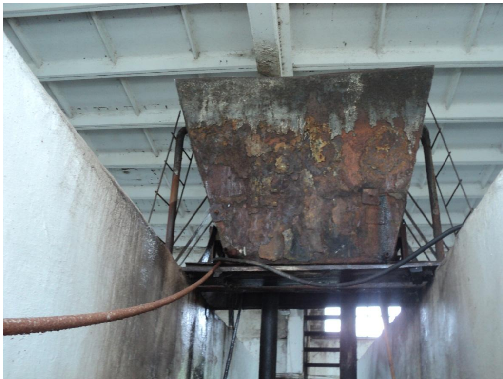
Фото 2.37 Очистные сооружения (с. Коелга)
